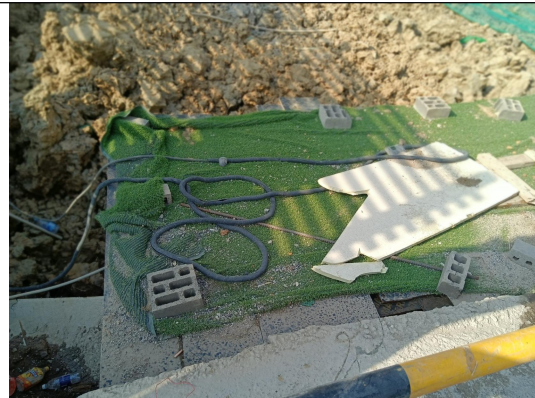
施工废水沉淀池
