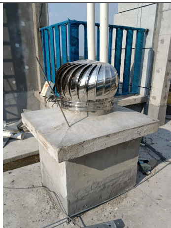
楼顶油烟排口
