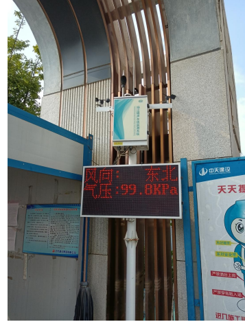
扬尘噪声在线监测系统
